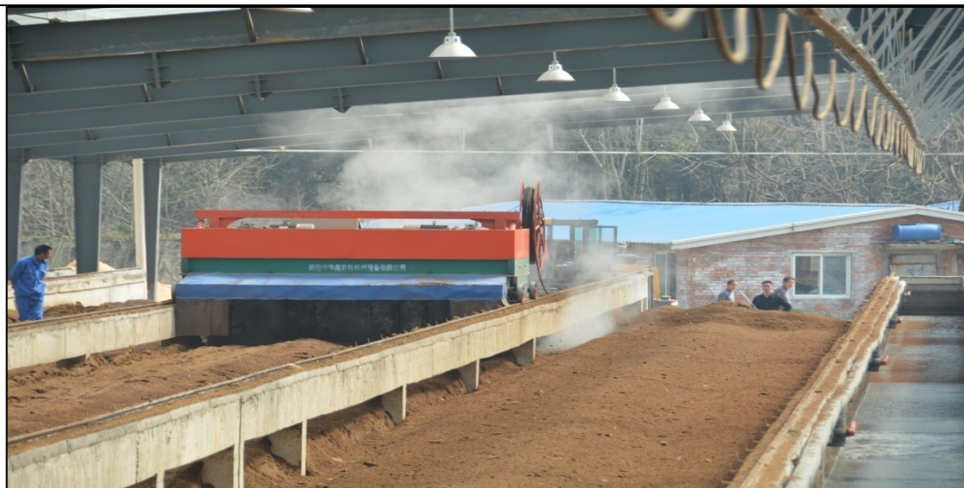
图 5.2-7 异位发酵床翻抛蒸气案例示例
